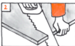
2. Découpez à l'aide d'une scie la plaque. L'idéal est d'effectuer ce travail à l'aide d'une scie circulaire (lame de carbure)
